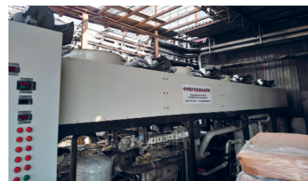
Моноблочная установка охлаждения жидкости
