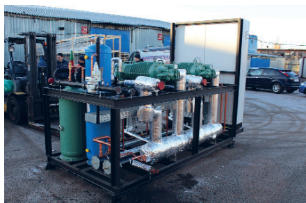
Установка охлаждения водного раствора этанола
