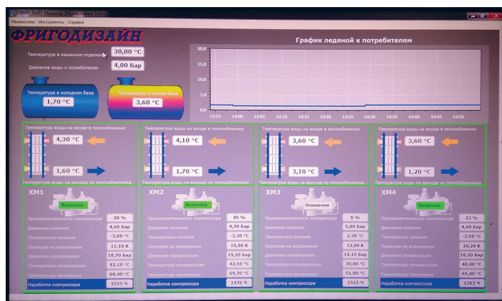
Экран панели управления и системы мониторинга холодильной установки
