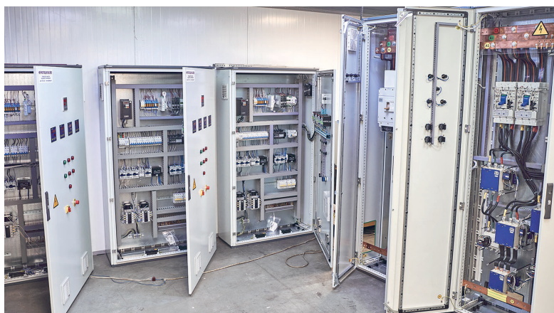
Участок сборки шкафов управления и мониторинга на производстве ООО «Фриготрейд»
