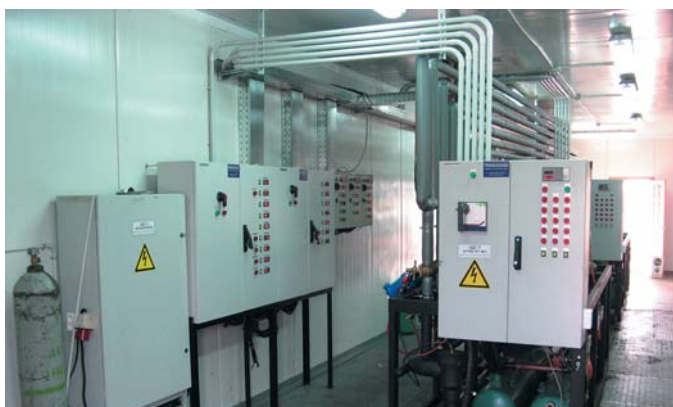
Электрические шкафы управления и мониторинга системы холодоснабжения производства «Фригодизайн»
