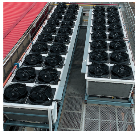
Конденсаторы холодильных установок
