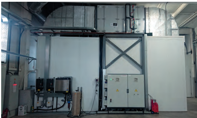
Воздуховоды между камерой и блоком подготовки воздуха
