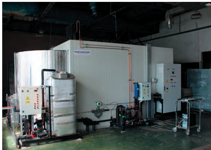
Холодильное оборудование климатической камеры
