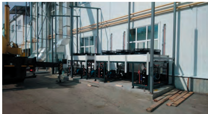
Холодильное оборудование испытательного климатического комплекса
