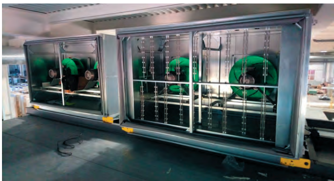
Блок подготовки воздуха на крыше камеры
