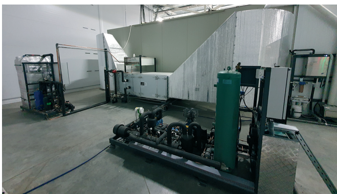
Блок подготовки воздуха с воздуховодами, компрессорно-конденсаторный агрегат и увлажнитель воздуха
