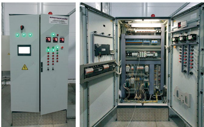
Шкаф системы управления оборудованием климатической камеры
