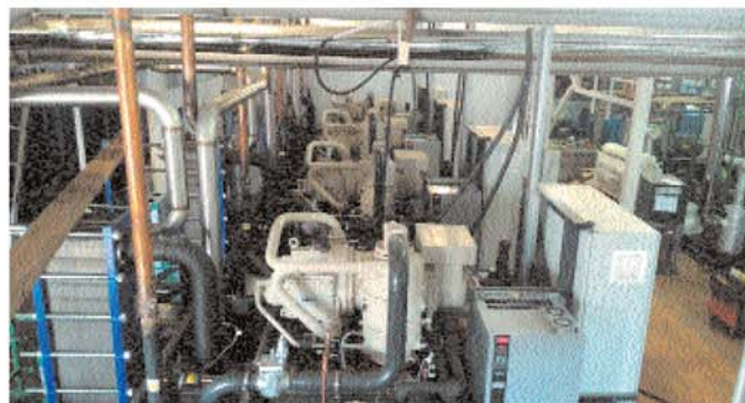
Генераторы ледяной воды компании «Фригодизайн» холодопроизводительностью 600 кВт каждый на молокозаводе в Волгоградской области
