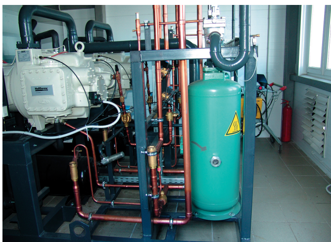
Холодильный агрегат на компрессорах J&EHall на «Московском хладокомбинате №14»
