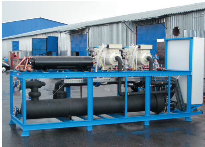
Установка ледяной воды на «Ивановском молочно-жировом комбинате»
