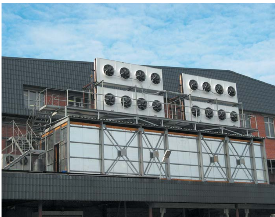
Воздушные конденсаторы CROCCO на контейнерной холодильной станции «Фригодизайн»
