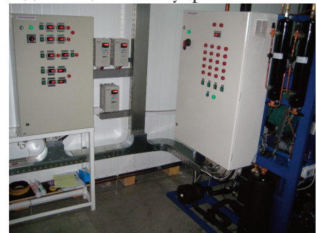
Рис. 1. Внешний вид щитов управления и трех частотных преобразователей системы хладоснабжения
