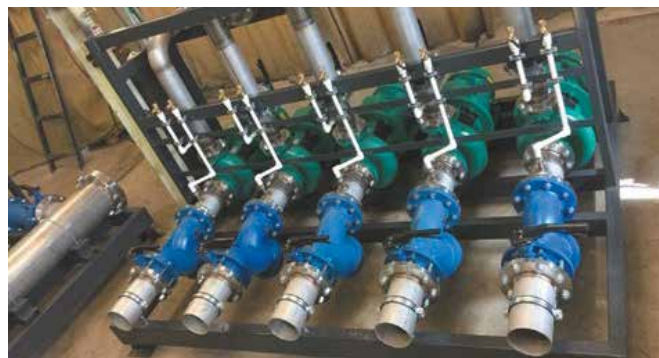
Рис. 5. Насосный агрегат для подачи ледяной воды с суммарным расходом 350 м³/ч на Еланском сыродельном комбинате
