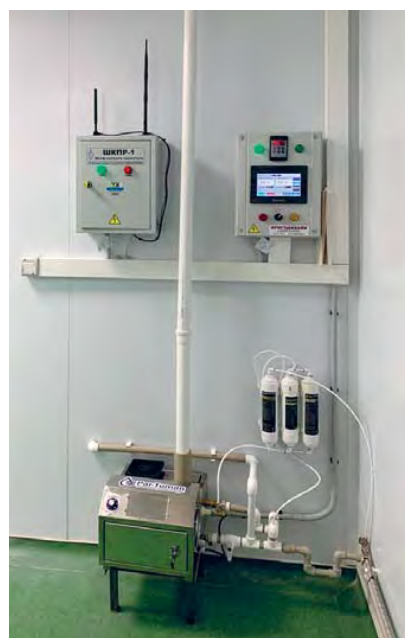
Шкаф управления с сенсорной панелью и ультразвуковой увлажнитель воздуха с фильтрами очистки воды
